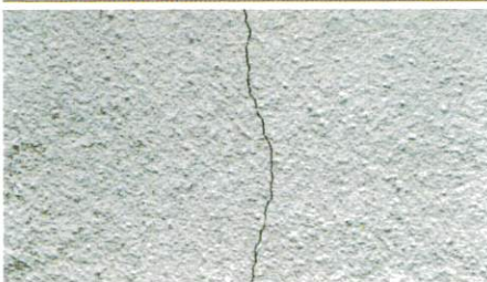
■ひび割れ発生
